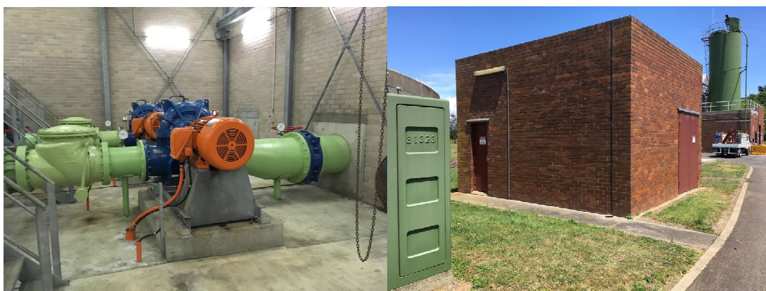
Малюнок 1: Водоочисна станція Wingecarribee та електрична підстанція з прилеглим майданчиком для стаціонарного генератора
